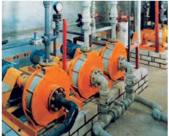
Chemie-Normpumpen Typ CPDR in einer Konzentratbehandlungsanlage (aggressives Prozesswasser)
